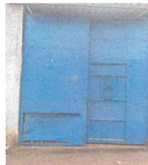
Foto 4: Reparacion de porton.
